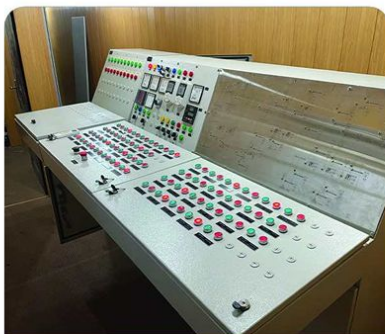
تابلو حفاظت و کنترل فرمان
